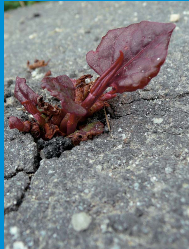
Ein neuer Trieb bricht den Asphalt auf.
